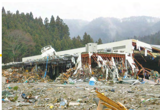
被災した岩手第三冷蔵庫。屋根にクレーナーが乗っている
