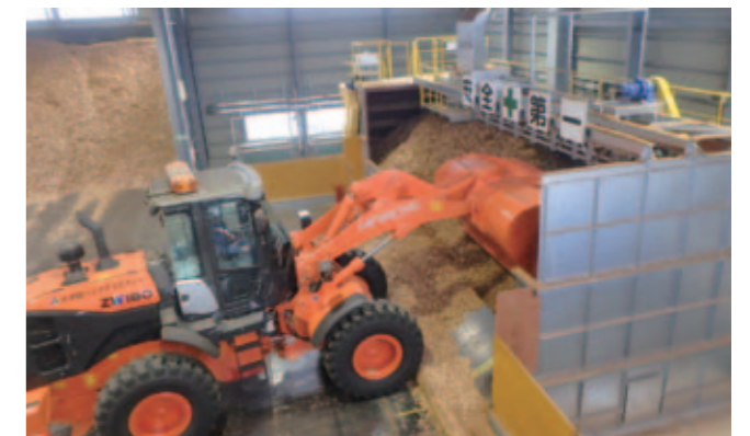
燃料定量フィーダーへ燃料投入風景
