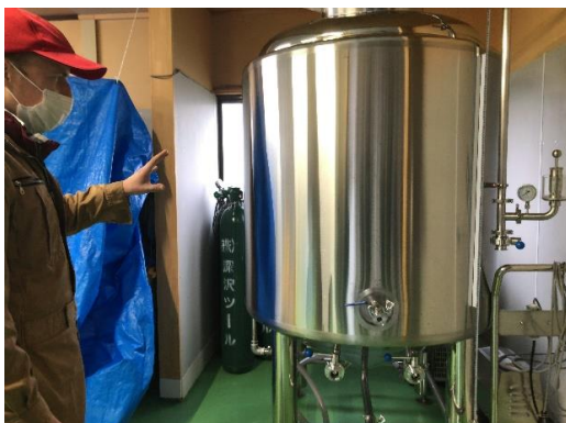
《醸造施設内(耐圧タンク)》
