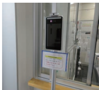
給食センター入口に設置している非接触検温器
