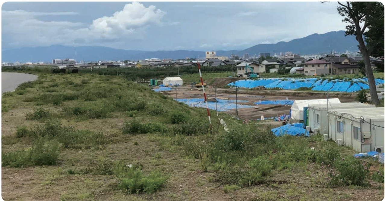
千曲川左岸の堤防決壊現場周辺（長沼地区）
