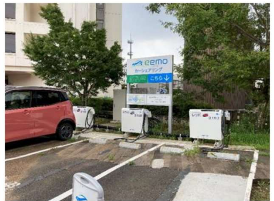
小田原市役所のEVステーション 出典：ヒアリング時撮影
